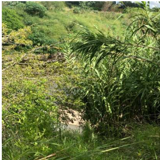
Emisario 11- Cañaveral impide el acceso
