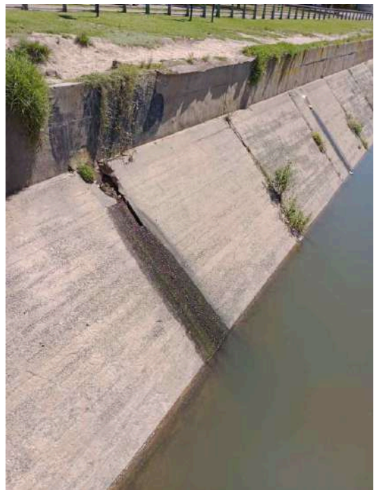
Punto AI-2 y EN-3. Descarga de pluviales
