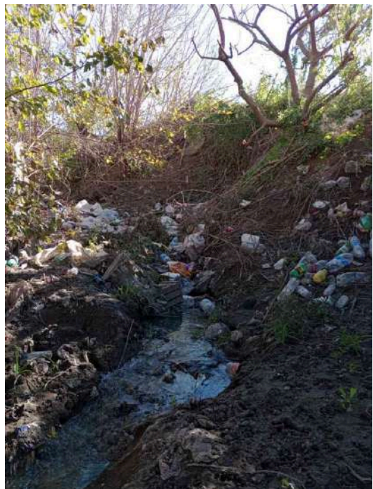
Punto EBOUN-1.. Residuos sobre conducto pluvial
