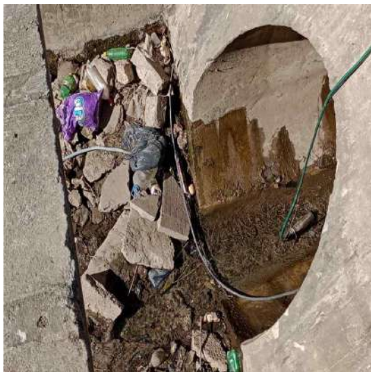
Punto E33-1. Emisario 33. Residuos y escombros
