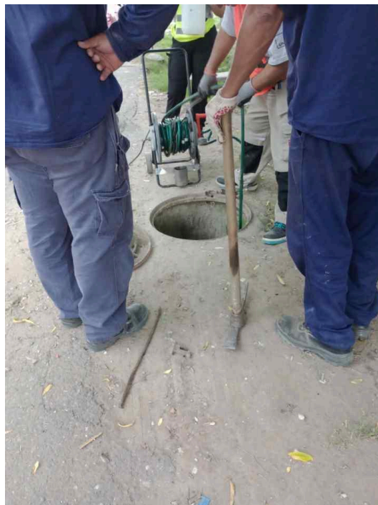
Punto ESCH-4. Cámara de Inspección
