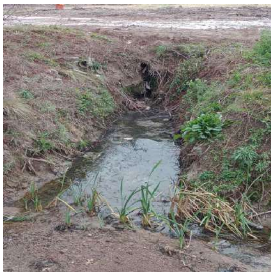
Punto ZPAZ-2 .Agua estancada, sin descarga de efluentes
