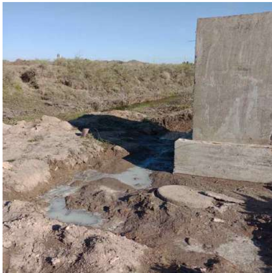
Punto 1- Vista de la obra de ASSA finalizada con restos de líquidos que podrían asociarse con cloacales
