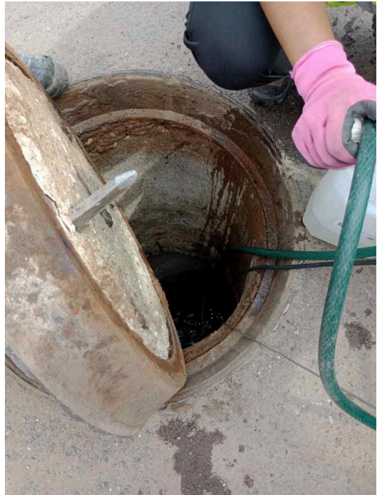
Punto E26-1- Toma de muestra en cámara de inspección ubicada en Alvarez Condarco y La República
