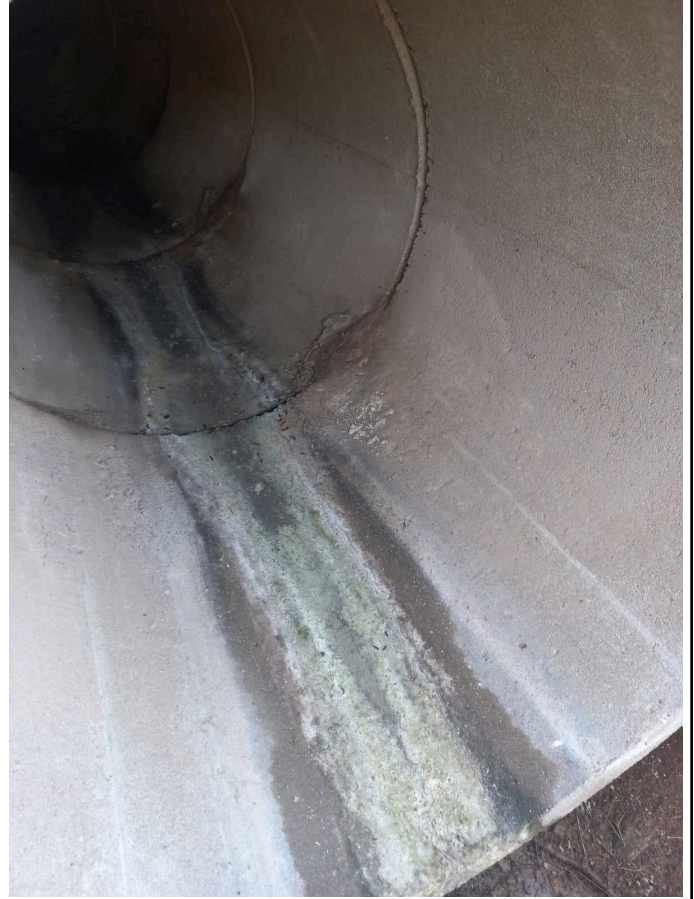
Interior del conducto- Se observa marca de agua. Fecha 23/01/2026
