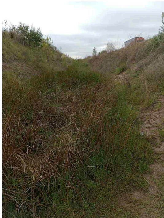
Punto I-LS-10 - Desague de Rosario sin descarga
