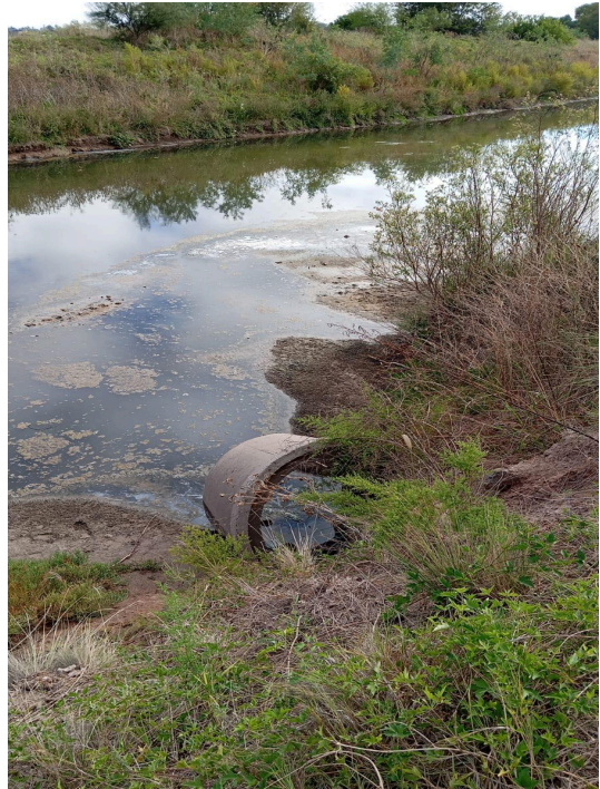
Punto II-LS-20 - Arroyo Ludueña margen derecha a la altura de descarga conducto pluvial Los Pasos del Golf
