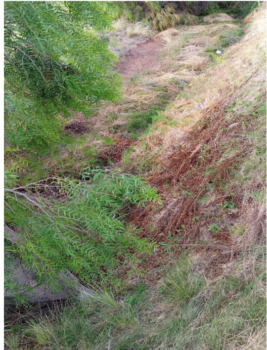
Conducto pluvial abierto (Zanja) Barrio Los Pasos del Golf Fotografía tomada desde afuera del barrio
