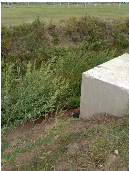
Punto II-LS-40 - Boca Registro ASSA ubicada sobre Zanja de Funes
